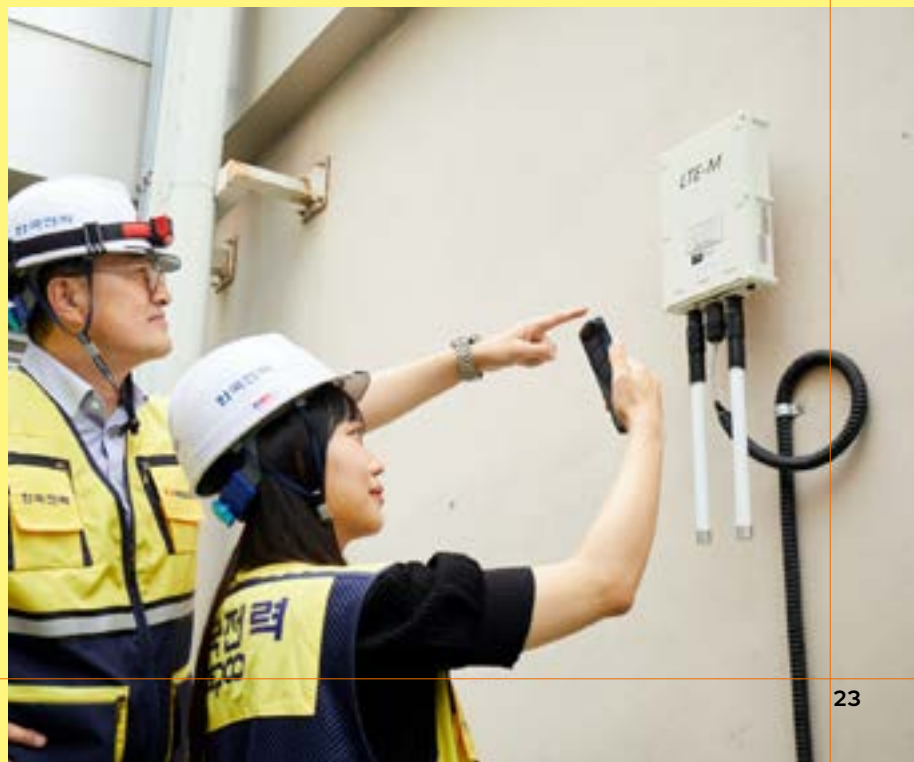
옥상에 설치된 PS-LTE 송수신기.
